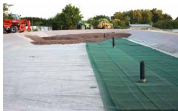
Août 2009 : installation de la rivière souterraine au fond du bassin de filtration et remplissage du filtre en roche volcanique.
